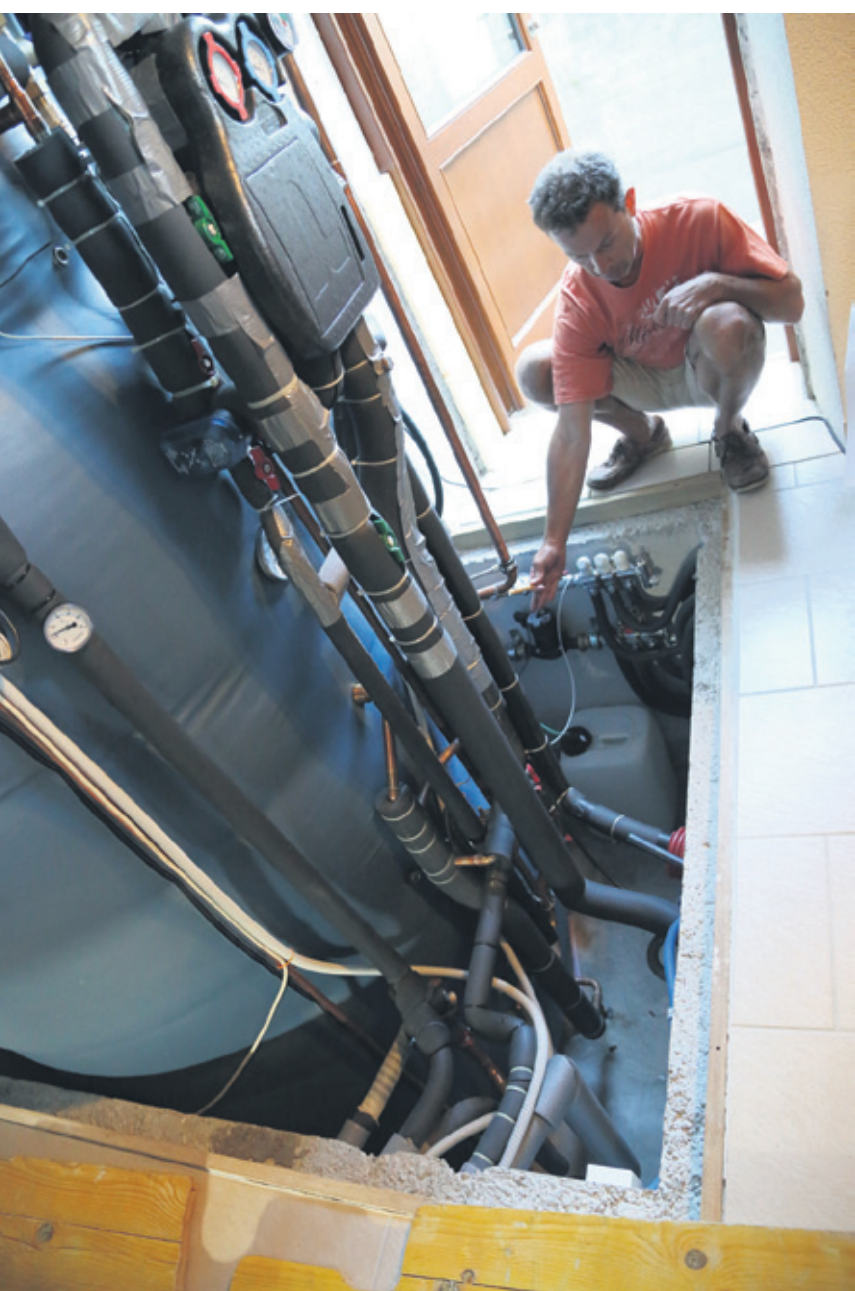
Le stock d'eau de Pierre Lavanchy, situé dans sa maison familiale, compte trois circuits: un destiné aux radiateurs, un deuxième pour l'eau chaude sanitaire, et le troisième pour les capteurs.
