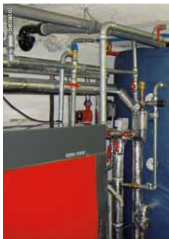
L'optimisation technique de la chaufferie.
